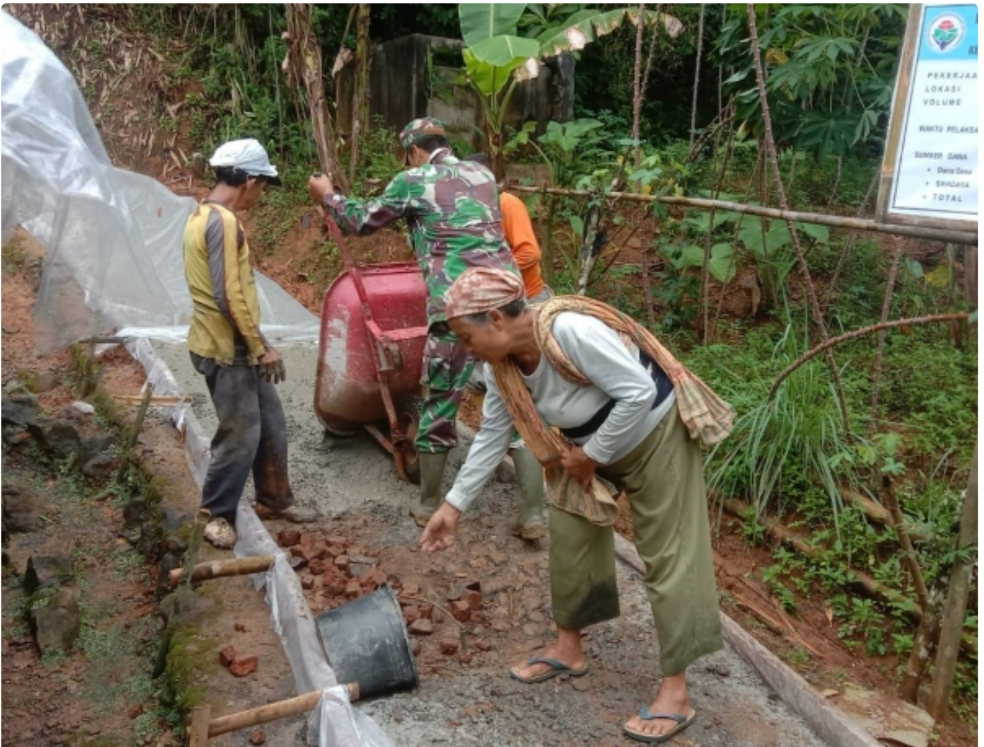
Sertu Teguh Raharjo Babinsa Koramil Sempor melaksanakan kerja bakti pembuatan rabat beton di wilayah dukuh Pesucen RT 05/04 Desa Semali
